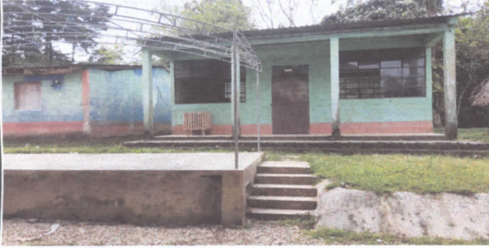
Anexo 1: cambiar puertas de madera por metal de las aulas.
