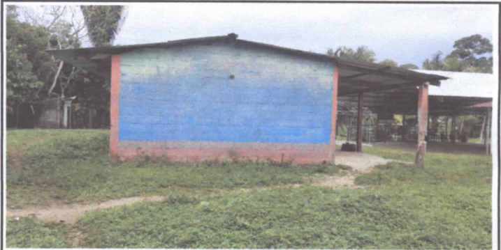
Anexo 4: pintar aula y cambiar lámina.
