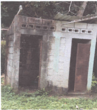
Anexo 3 baños: sustituir las puertas de los baños y lámina.
