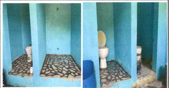
Foto 4: instalación de piso cerámico en forma de mosaico en los sanitarios finalizada.
