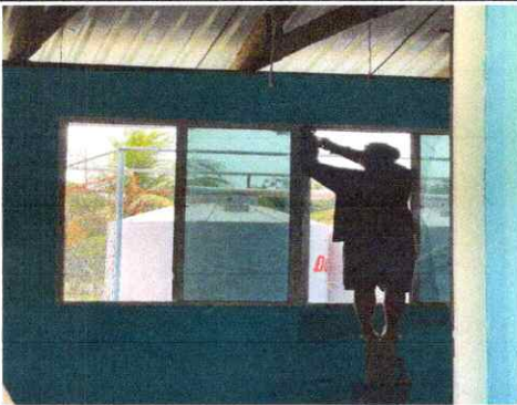
Foto 3: REPARACIÓN DE VENTANA EN MAL ESTADO.
