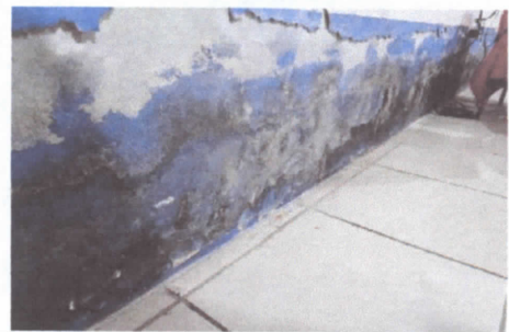
Foto No.6: Humedad en pared
