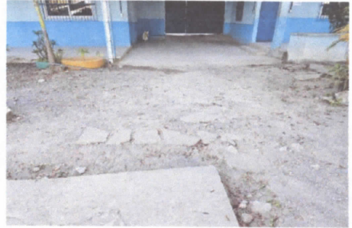
Foto No.2: Caminamiento en mal estado
