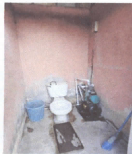
Foto No.5: Inodoro en mal estado
