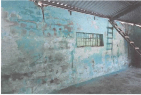
Foto No.1: Pared dañada y fracturada
