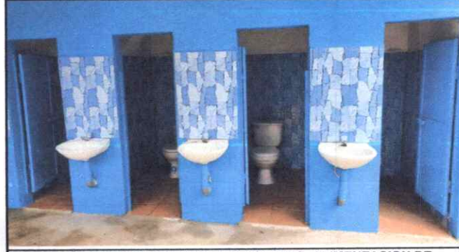
Foto 4: SUSTITUCION DE DRENAJES, AZULEJO, ALIMENTACION DE AGUA TECHADO Y GALERA EN SANITARIOS
