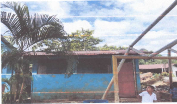
foto 1: lamina en mal estado
