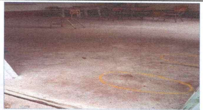
Foto 4: Sustrucion por piso ceramico
