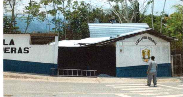
Foto 2: Evidencia de sustitución de lamina acanalada a lamina troquelada en un ala de los servicios sanitarios.
