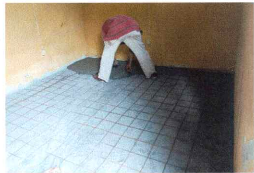
Foto 4: Evidencia de instalación de electromalla y reparación de piso liso en dirección.
