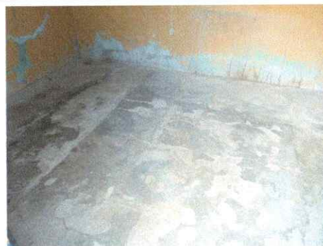
Foto 4: Evidencia del piso de la dirección en mal estado.
