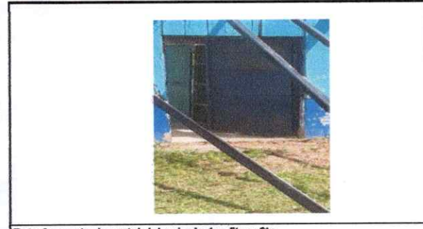
Foto 6: puerta de metal del aula de 1ro,5to y 6to
