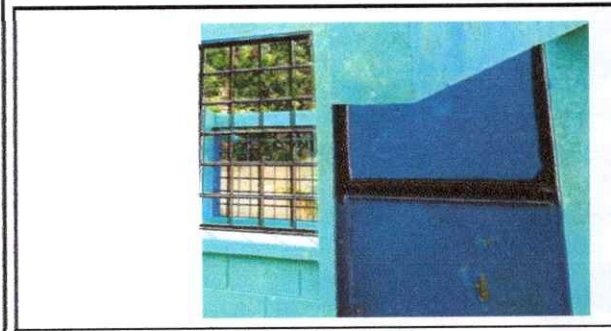
Foto 5: puertas de metal del aula de 2do, 3ro y 4to
