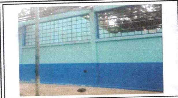
Foto 1: ventanas por pintar del aula de 2do, 3ro y 4to primaria
