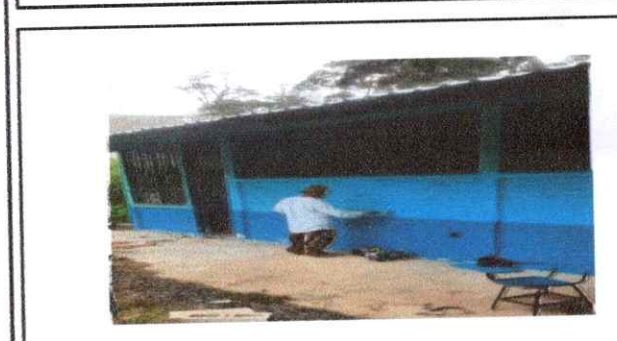
Foto 3: pintura en muros interiores del aula de 2do, 3ro y 4to
