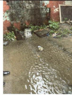
Foto 2: Módulo A, inundación en pasillo exterior
