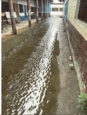
Foto 1: Módulo A, inundación en pasillo
