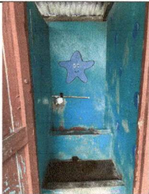
Foto 9: Módulo C, sanitario en mal estado
