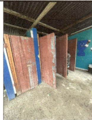
Foto 8: Módulo C, sanitarios en mal estado
