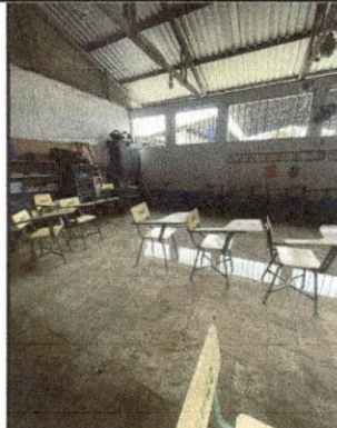
Foto 3: Módulo B, aula inundada
