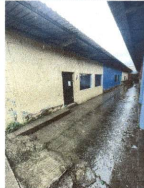
Foto 4: Módulo A, pasillo inundado
