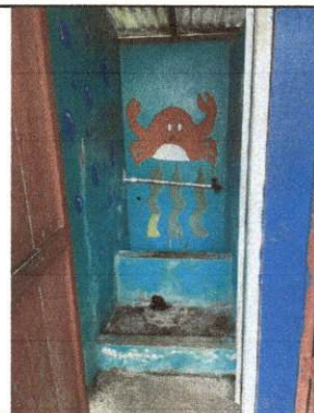
Foto 6: Módulo C, sanitarios en mal estado
