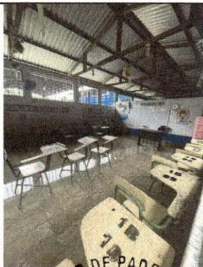
Foto 5: Módulo B, aula inundada
