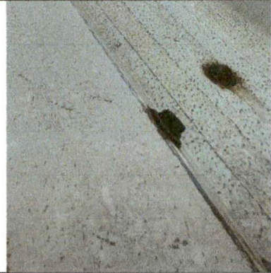
Foto 2: Módulo A, tornillos en mal estado
