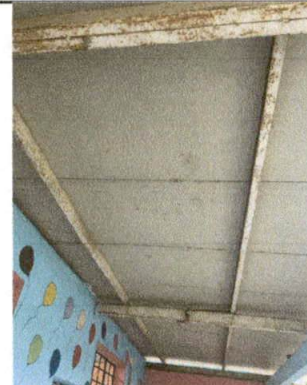
Foto 4: Módulo A, estructura metálica oxidada
