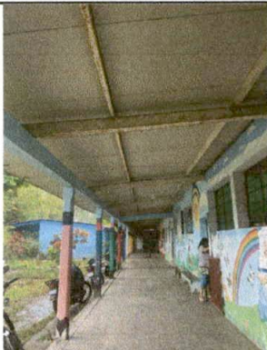
Foto 3: Módulo A, estructura metálica en mal estado
