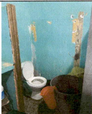
Foto 9: Módulo B, sanitarios en mal estado
