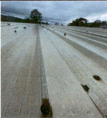
Foto 1: Módulo A, tornillos de lámina en mal estado
