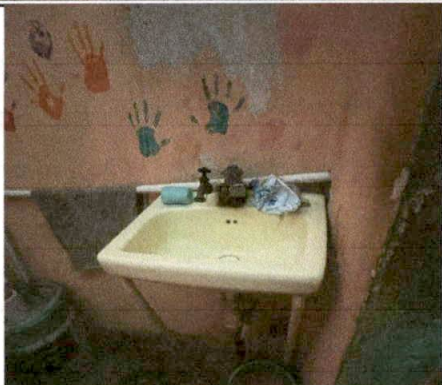
Foto 7: Módulo B, muros deteriorados
