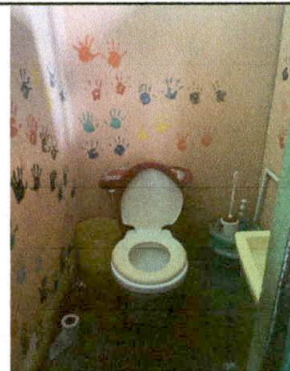
Foto 6: Módulo B, inodoros en mal estado
