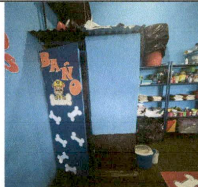
Foto 10: Módulo B, puertas en mal estado
