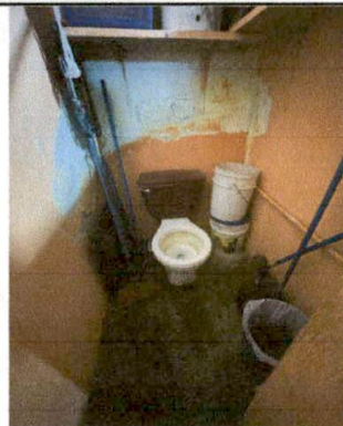
Foto 8: Módulo B, muros y pisos en mal estado
