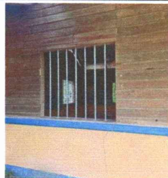
Foto 4: Ventana en mal estado
