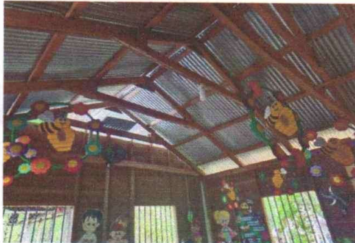
Foto 1: Lámina en mal estado
