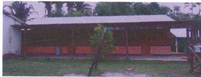
Foto 2: Lámina en mal estado
