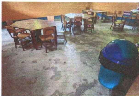
Foto 3: Piso en mal estado
