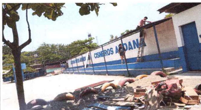
SUTTICION DE LAMINAS Y ESTRUCTURA DE METAL DE LA GALERA
