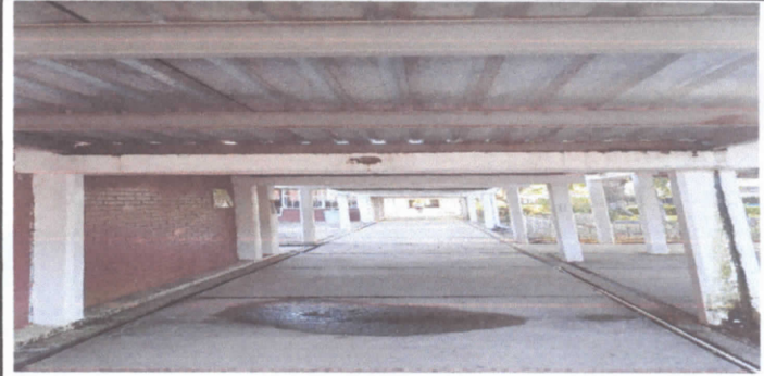
Foto No. 6 Techo de Pasillo de Área de Audiovisuales
