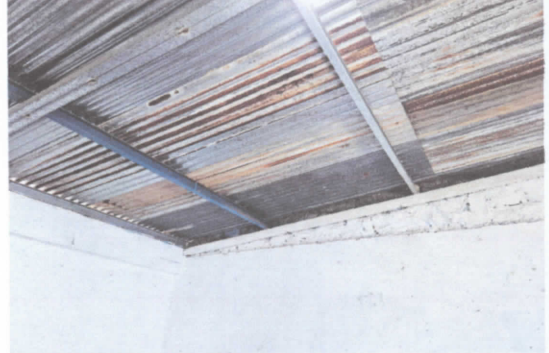
Foto2: lámina en mal estado
