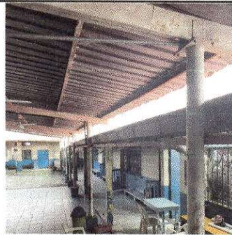
Foto 10: Estructura metálica presenta oxidación.
