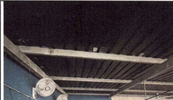
Foto 8: Estructura metálica presenta oxidación.
