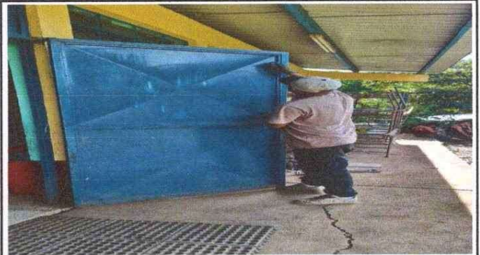
Foto 2: Puertas en mal estado
