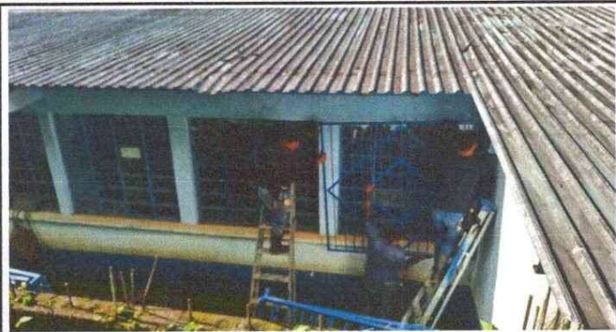
Foto1: Ventana en mal estado
