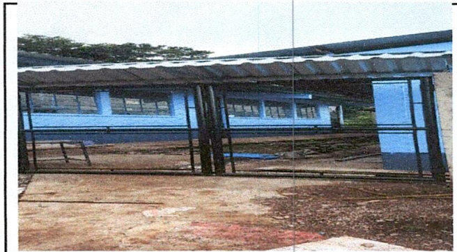
Foto1: Sustitución de pintura inferior e exterior
