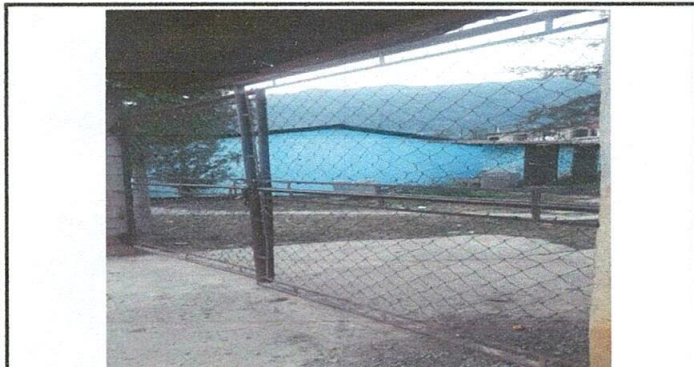
Foto 5: Portón en mal estado
