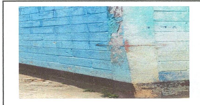
Foto 6: Paredes en mal estado
