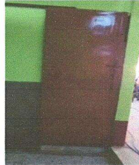
Foto 2: Puertas para los baños
