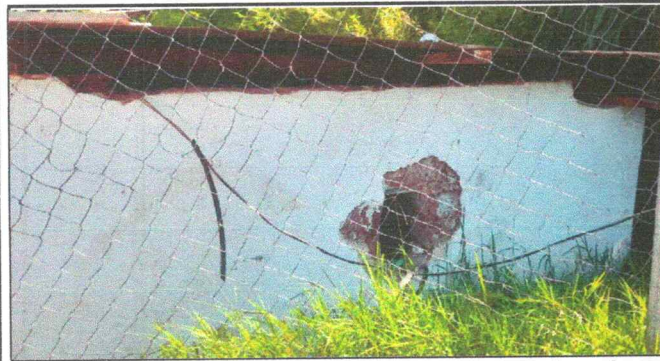
Foto 3: fotografía de un lado de la cocina que esta a punto de derrumbarse por las fuertes lluvias
