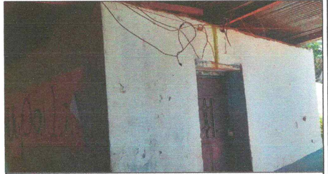
Foto 2: fotografía de la cocina demasiado pequeña y entra el agua no se puede cocinar
