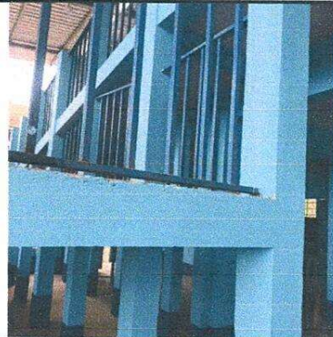
Foto 4: Aplicación de pintura finalizada en el área de rampa de acceso al segundo nivel.
