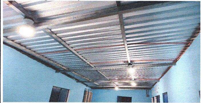
Foto 20. Bombillas y apagadores funcionando al 100%
