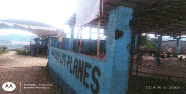
Foto 17: Los Muros perimetrales se encuentran incompletos.
