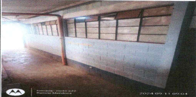
Foto 16: La pintura de las aulas estan muy desgastadas
