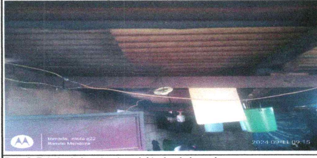
Foto 5: Estado de la estructura del techo de la cocina
