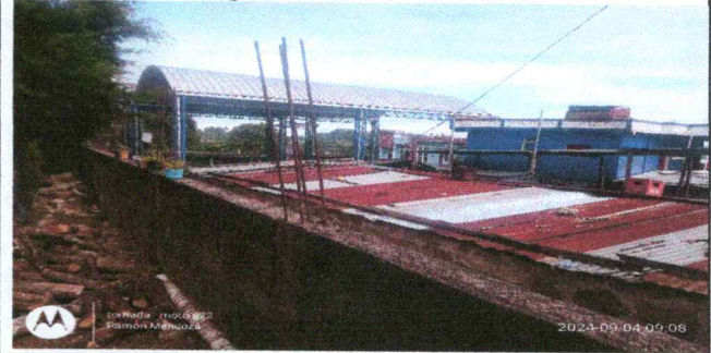
Foto 18: Muro Perimetral incompleto
