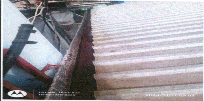
Foto 14: Estado fisico del canal de agua pluvial de metal
