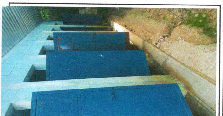
Foto 4: Estado en que se encuentran las puertas de los baños.
