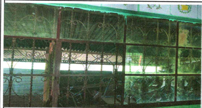
Foto1: estado en que se encuentran los vidrios y ventanas del Establecimiento.
