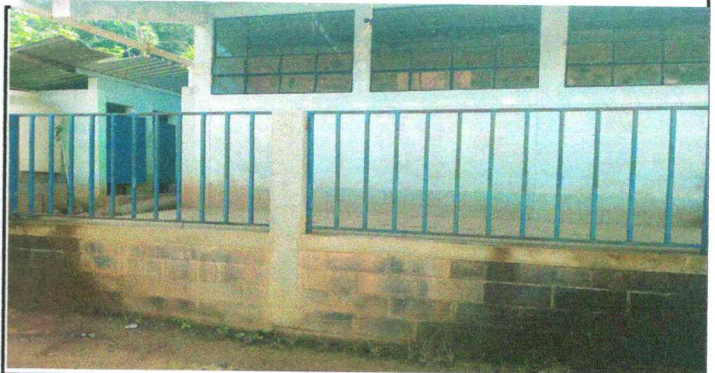
Foto 6: Barandales que se encuentran en mal estado
