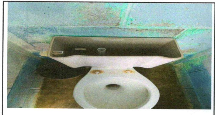
Foto 3: Estado en que se encuentran las tazas de los baños, paredes y piso.
