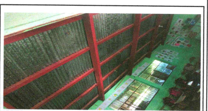
Foto 6: Estado en que se encuentra la madera del Centro Educativo
