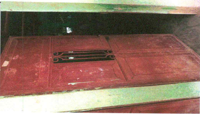
Foto 3: Estado en que se encuentran las puertas del centro Educativo.
