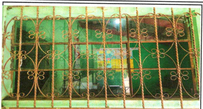
Foto 2: Estado en que se encuentran los balcones del Centro Educativo.
