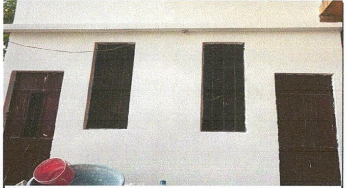
Foto 4. Repello de cocina
