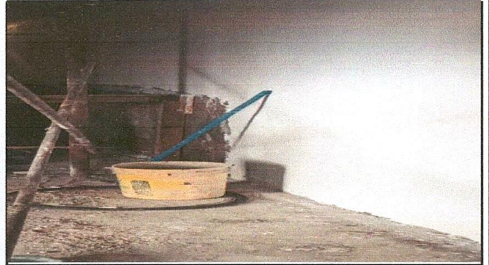
Foto 2. Repello y piso de aula, párvulos 1
