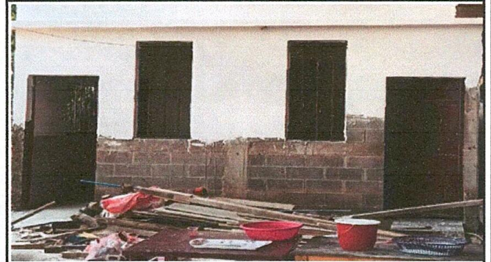
Foto 4. Repello de cocina
