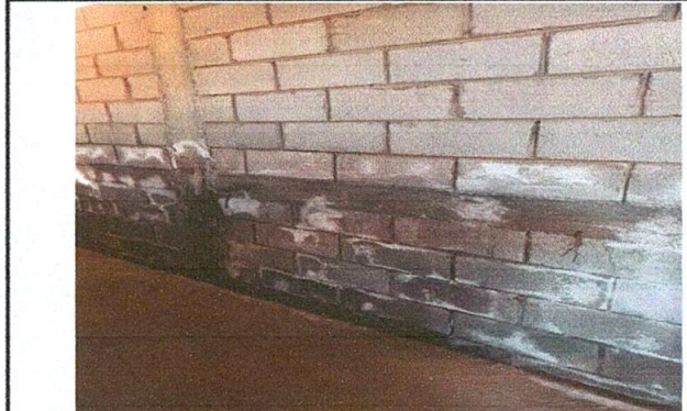
Foto 2. Repello y piso de aula, párvulos 1
