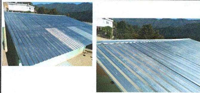
Foto 1: Lámina de módulo de aula en malas condiciones con varias goteras en lluvia
