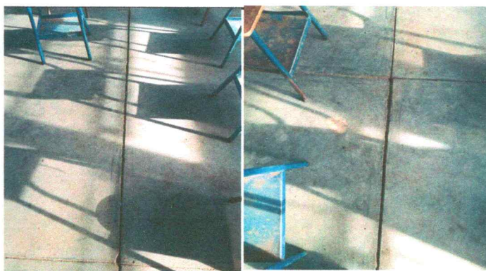
Foto 4: Otras evidencias del piso en mal estado y grietas
