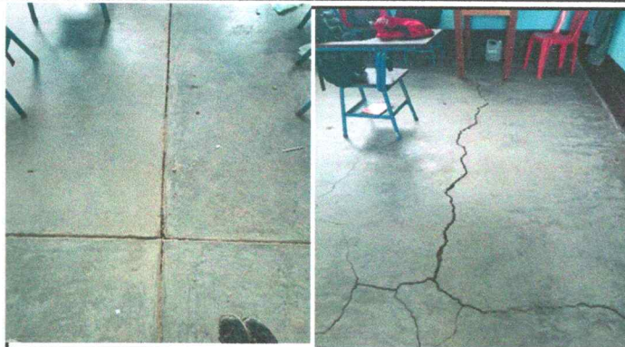
Foto 2: Otras evidencias del mal estado del piso que se quiere sustituir.
