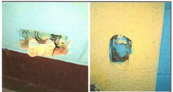
Foto 2: Se necesita la sustitución de interruptores y de tomacorrientes
