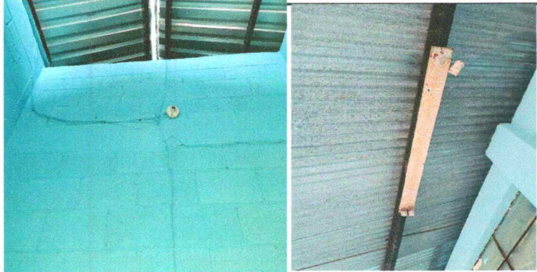
Foto1: Se evidencia la necesidad de cambiar lámparas, focos y nueva instalación.
