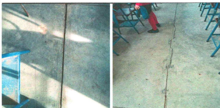
Foto 5: Se evidencia las grietas en el piso
