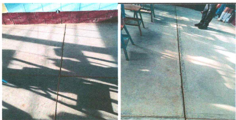
Foto 3: Otras aulas que necesitan la sustitución de piso
