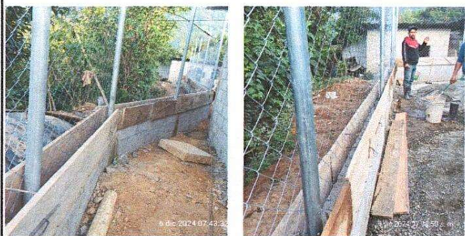
Foto 1: Reparación de muro perimetral de block, tubo hg, malla galvanizada, soleras intermedias y columnas.
