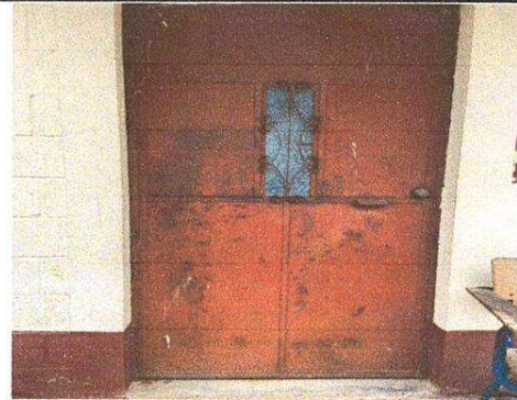
Foto 2: Puertas en mal estado total 6
