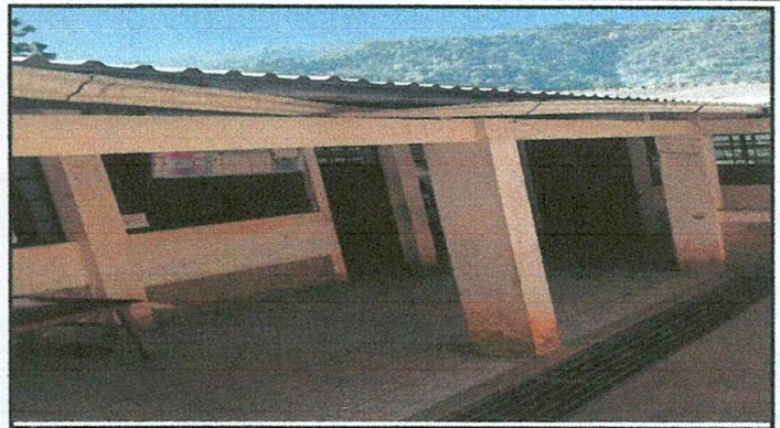
Foto 2: Pintura de las paredes del establecimiento, cambio de canales de PVC y mantenimiento de estructuras ventanales.
