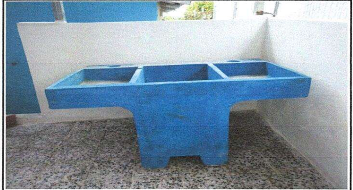
Foto 20: pila de cemento de 2 lavamanos
