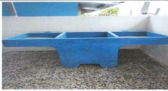
Foto 19: pila de cemento de 2 lavamanos
