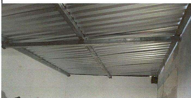
Foto 3: Cubierta de lámina en mal estado
