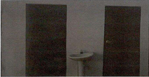
Foto13: Sustrucción de puerta de metal en servicio sanitario
