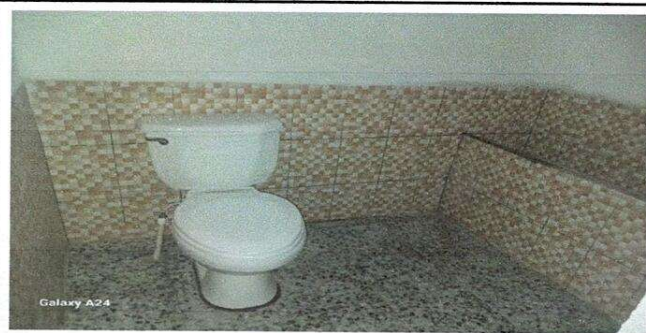
Foto 23: Azulejo en baño
