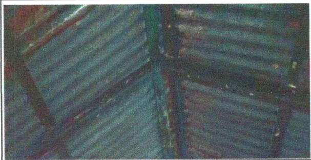
Foto 7: Estructura de techo en mal estado
