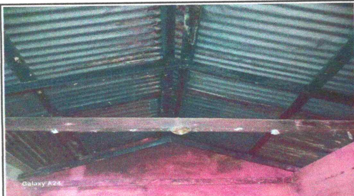
Foto 3: Cubierta de lámina en mal estado
