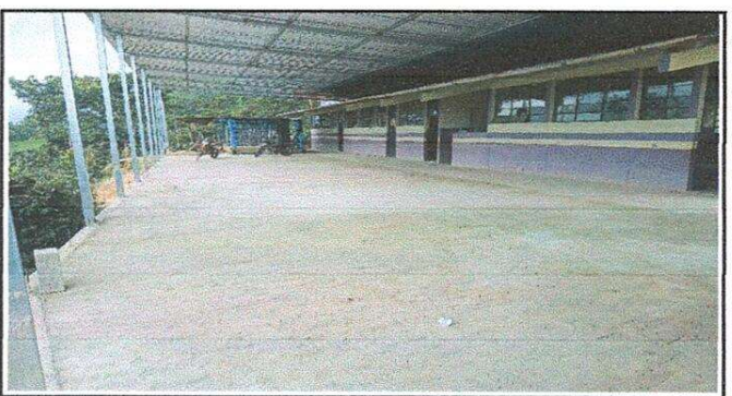
Foto 6: Vista de la fase final de la torta de concreto en el establecimiento educativo.
