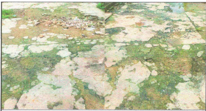
Foto 5: Piso deteriorado que necesita sustituirse.
