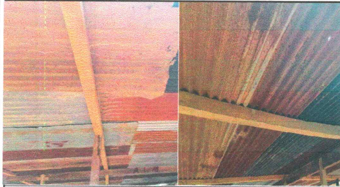
Foto 1: Láminas viejas que necesitan sustituirse.
