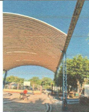
Foto 2: Área de techo de cancha polideportiva en mal estado lado norte
