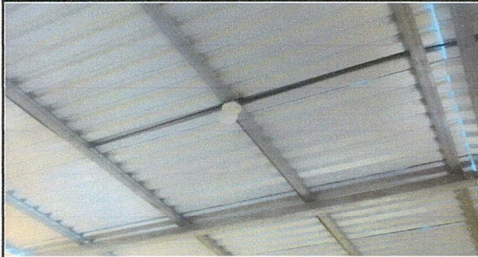
Foto1: Foco ahorrador instalado
