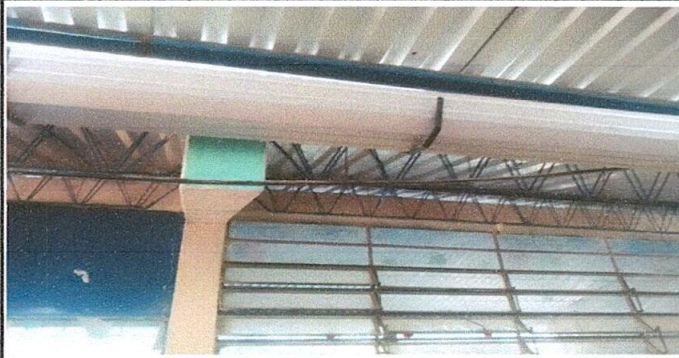
Foto 1: Canal de agua instalado
