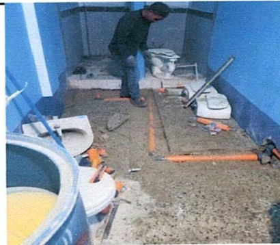
Foto 6: Servicios sanitarios y sus accesorios
