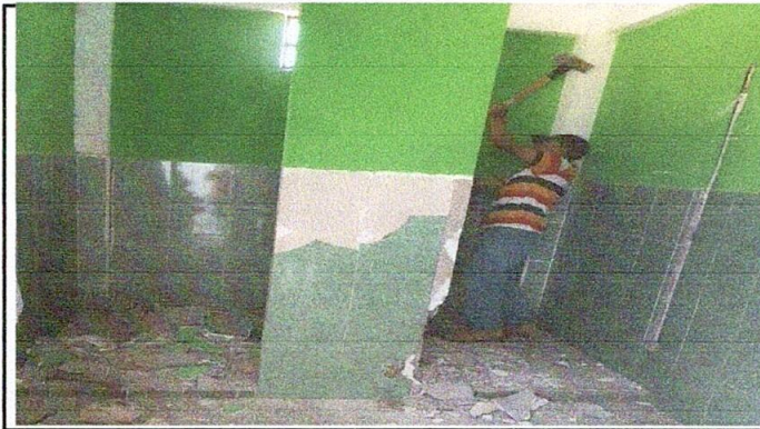
FOTO 3 10 SERVICIOS SANITARIOS Y SUS ACCESORIOS, división de dos a cuatro sanitarios para niñas.
