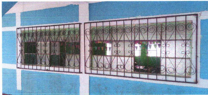
Foto 3: Los ventanales y vidrios estan en mal estado.
