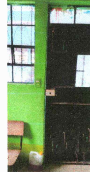
Foto 2: Chapas de las puertas, en mal estado.
