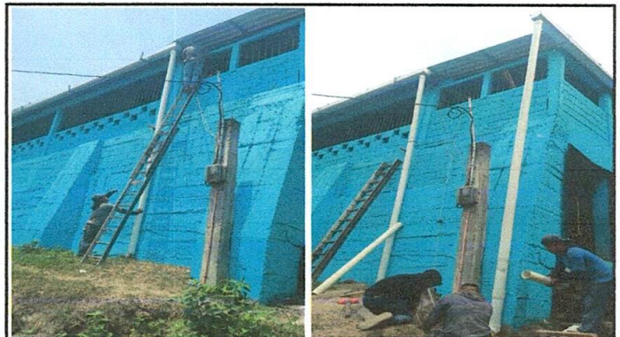
Foto No. 10 Aquí se onserva que se esta colocando las bajadas de agua pivial en los canales del centro educativo.
