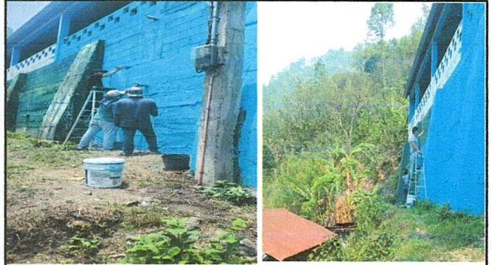
Foto No. 8 Se esta pintado el muro y las aulas del centro educativo.
