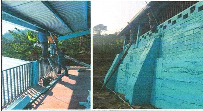
Foto No. 1 En estas imágenes se observa que se esta trabajando este renglon de trabajo de colocación de canales en el centro educativo.
