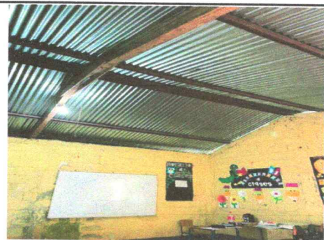
Foto 4: Laminas de las aulas.
