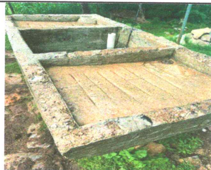
Foto 6: Pila en mal estado
