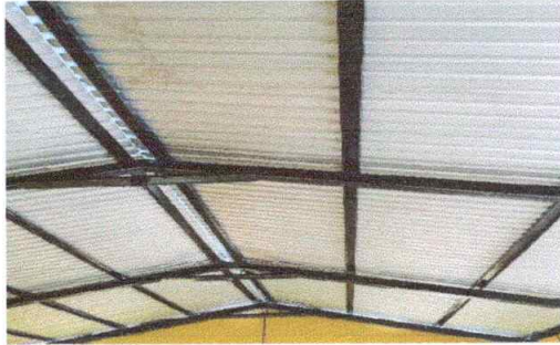
Foto 1: lámina en malas condiciones
