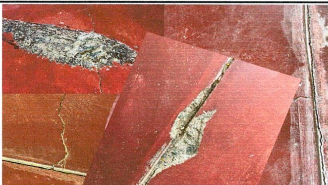
Foto 3: Piso en mal estado.
