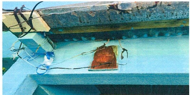
Foto 6: Canaletas en mal estado.
