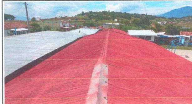
Foto 2: Camote en mal estado
