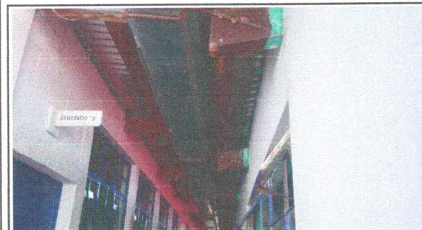
Foto 3: Estructura de madera picados y en mal estado
