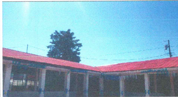
Foto 1: Tejado de lámina en mal estado
