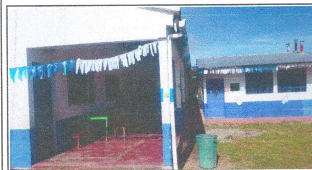
Foto 5: Canal en mal estado
