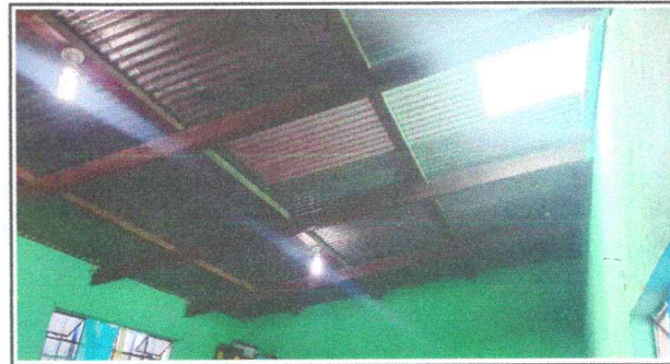
Foto 4: Estructura de madera en mal estado
