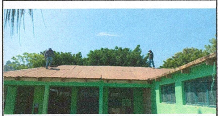
Foto 4: La oxidación ha transformado la apariencia del techo, dándole un aire de decadencia y abandono.
