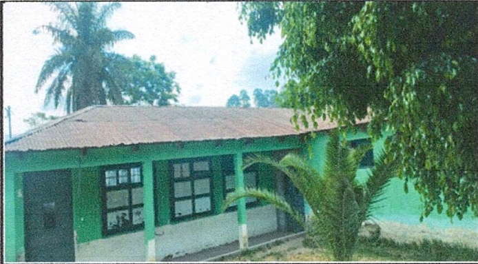
Foto 1: Los paneles, antes uniformes, se ven ahora deformados y doblados, como si la fuerza del tiempo los hubiera retorcido a su antojo.
