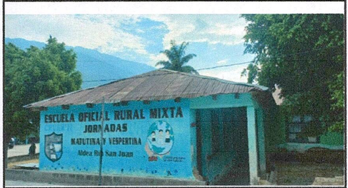
Foto 2: El techo, una vez robusto y protector, ahora yace retorcido y corroído por el paso del tiempo. El óxido ha invadido cada centímetro, pintando su superficie con tonos de marrón y naranja.
